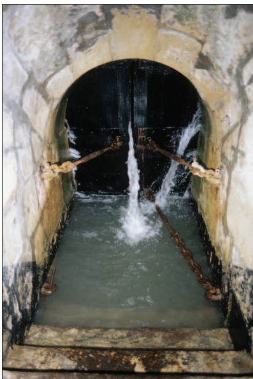
L'océan, qui frappe violemment la porte d'entrée, pénètre par les interstices et fait grimper le niveau d'eau dans le tunnel. Photo Claude Businelli © collection CEG
